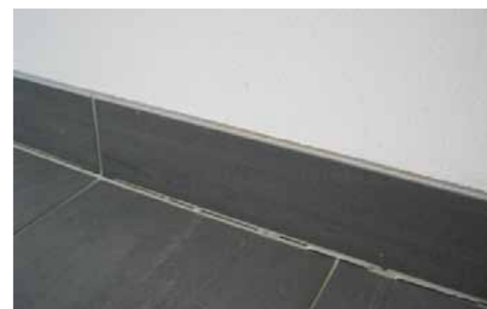
Obr. 23 – Potrhaná dilatační spára bez použití separačního provazce
